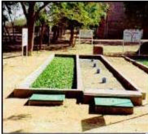
Figure 3.4: Bassins du niveau 2 alimentés en parallèle; dans cette configuration bassin à laitues d'eau (à gauche) et filtre horizontal à gravier (à droite)
