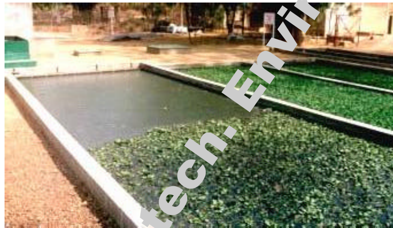
Figure 7.4: Remontée et accumulation de boues à la surface du premier bassin - dépérissement de Pistia stratiotes sous fortes charges organiques, (en premier plan laitue d'eau à la sortie du bassin).
